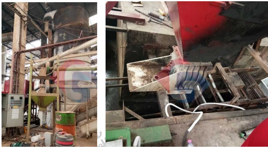
รูปที่ 1 ระบบลำเลียงถูกไฟไหม้
