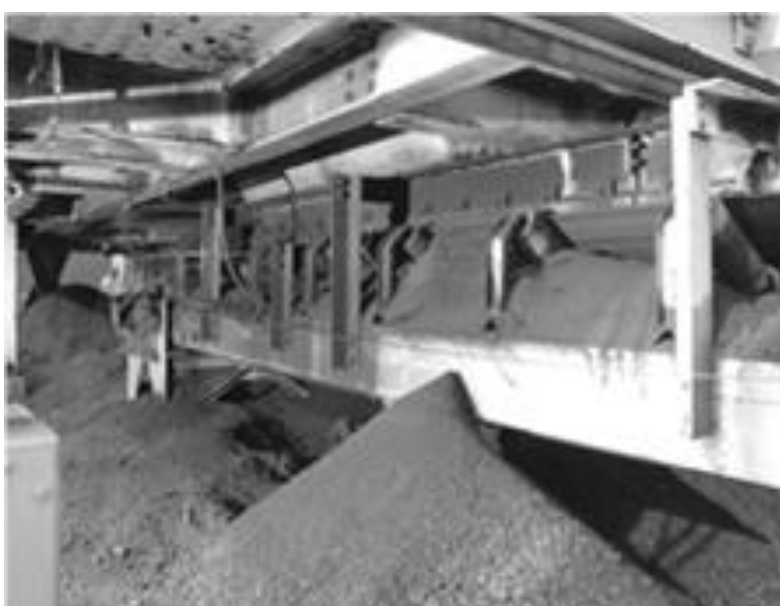
การติดตั้ง Wear Liner สูงจากสายพานมากเกินไปทำให้วัสดุ
